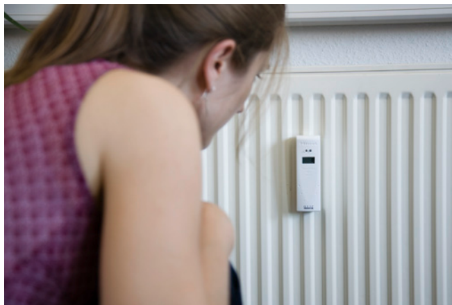
Zwischenablesung: Elektronische Heizkostenverteiler sind mit ihrem Klartext-Display für jedermann leicht ablesbar.
