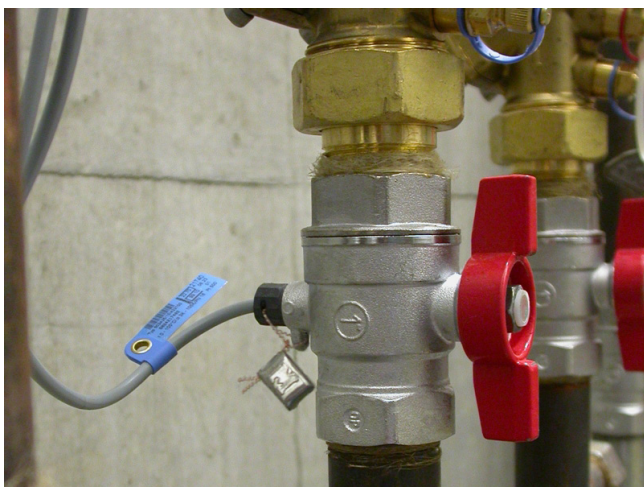
Abb 1: Beispiel für den Einbau eines Tauchfühlers im Kugelhahn, hier im Rücklauf des Wärmezähler.
