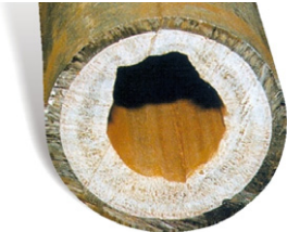
Abb. 4: So sieht eine Warmwasserleitung nach mehreren Jahren aus, wenn keine besonderen Maßnahmen ergriffen wurden, um Verkalkung zu verhindern.
