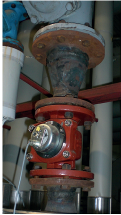
Foto 1 und 1a: Fehlende Beruhigungsstrecke vor einem Wolftmanzähler entgegen Anforderungen des Geräteherstellers
