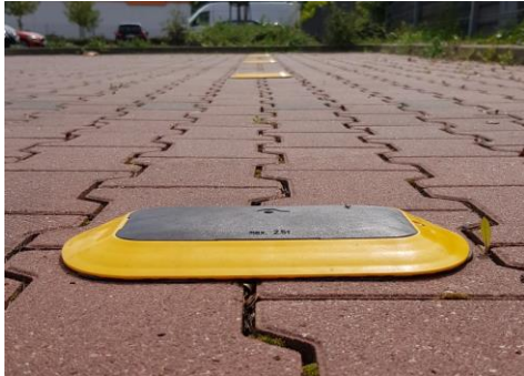
Bildunterschrift: Der Belegungszustand der Parkflächen wird durch Sensoren erfasst. (Quelle: Smart City System)
